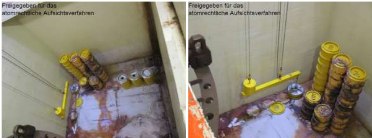
Der Spezialauslegerarm mit Winkelring-Deckel-Greifer bei der Kalthandhabung. Im Hintergrund die letzten 11 Fässer in der Kaverne 6 in sehr schlechtem Zustand (starker, großflächiger Rostbefall). (© KKB)
