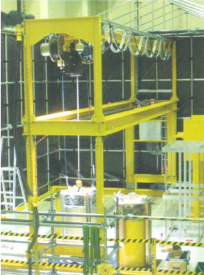
Der Portalkran innerhalb der Einhausung (© KKB)
