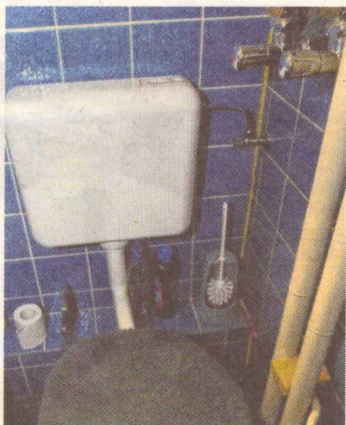
Die neuen Absperrventile stehen weit von der Wand ab und stören auf der Toilette.
